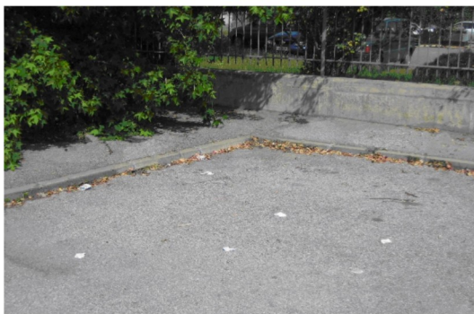
Fig. 10 – Livello di spazzamento insufficiente
